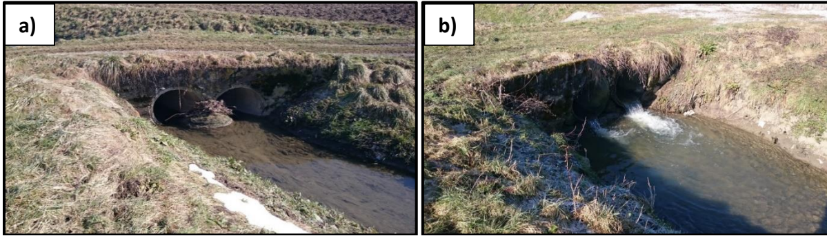
Slika 2.1-15. Stanje propusta: (a) PR5 (stac. km 4+584,6), (b) PR6 (stac. km 5+072,8), (izvor: Institut IGH d.d., 2017.)
