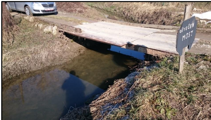
Slika 2.1-6. Stanje propusta PR4, stac. km 2+188,1 (izvor: Institut IGH d.d., 2017.)
