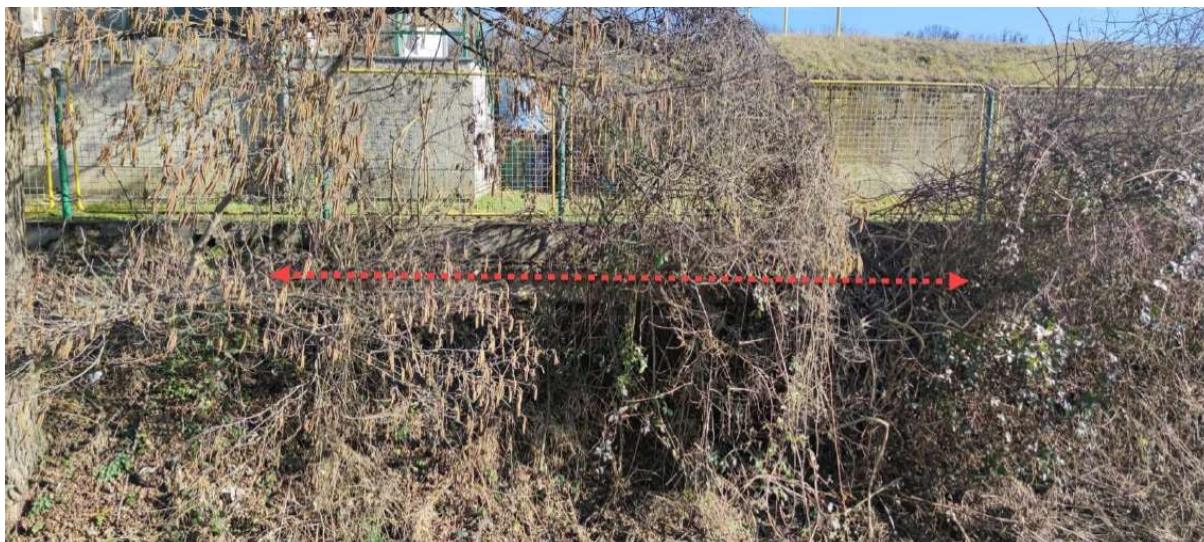
Slika 2-5. Podlokavanje ograde uslijed erozije (kraj dionice).
