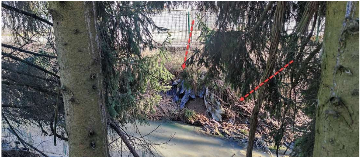
Slika 2-2. Erozija lijeve obale na početku dionice.
