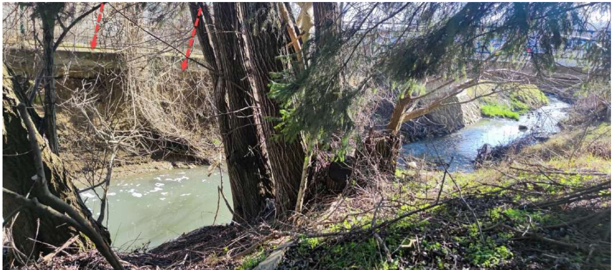
Slika 2-3. Podlokavanje ograde uslijed erozije (početak dionice).
