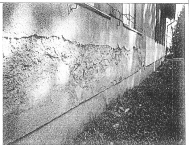
4. KUĆA, FASADA KOJA OTPADA
