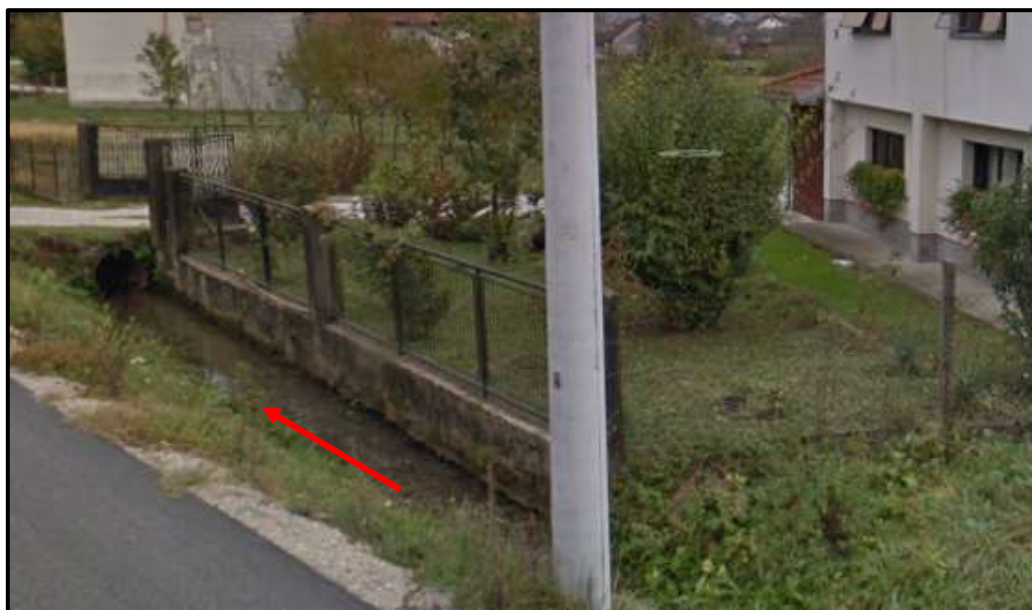
Slika 2.1-3. Korito potoka Velika Rakovica na najužem dijelu između ulice Črešni i betonske ograde jednog od dvorišta (izvor: Viacon, 2019. )
